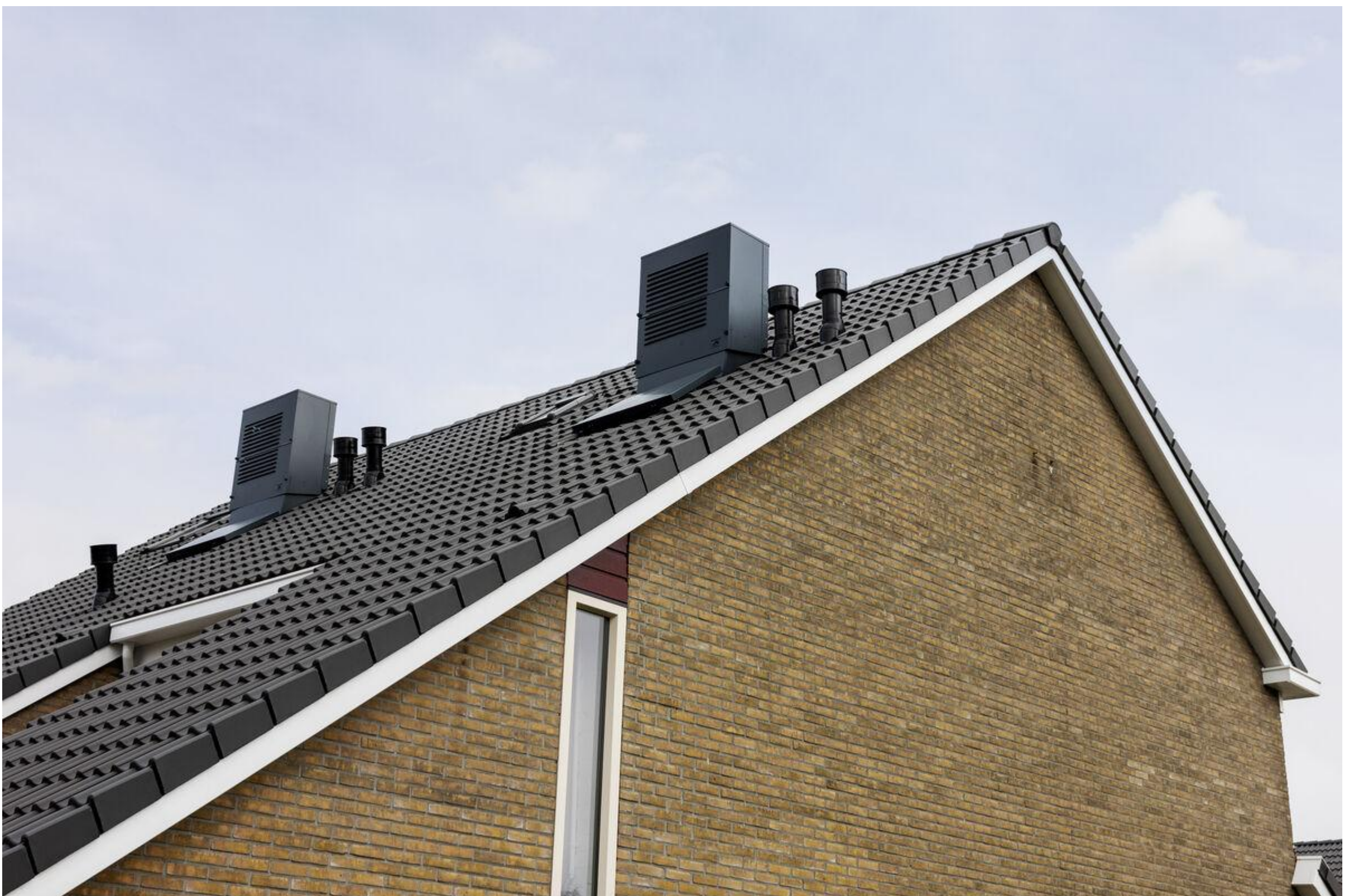
Voorbeeld van een buitenunit op het dak
